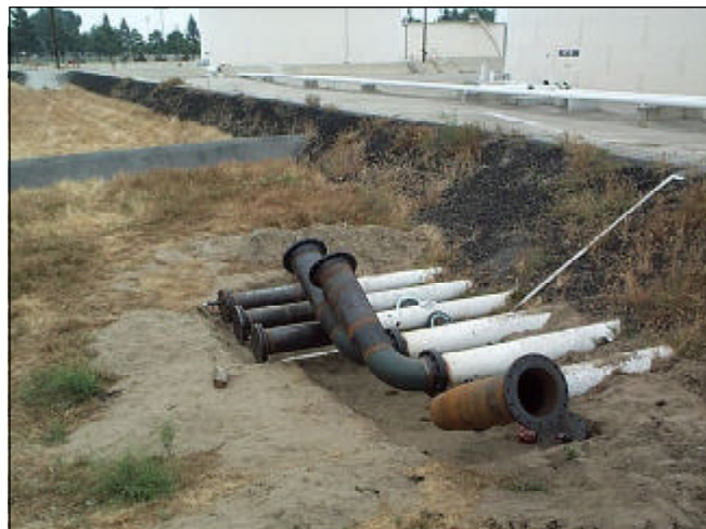
Limpieza de tuberías. Se acopló equipo a las tuberías principales para lanzar dispositivos de limpieza (llamados “pigs”). Todas las tuberías de DESC se encuentran vacías y limpias.
