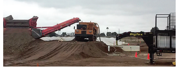
Sistema de tratamiento de suelo en el sitio
