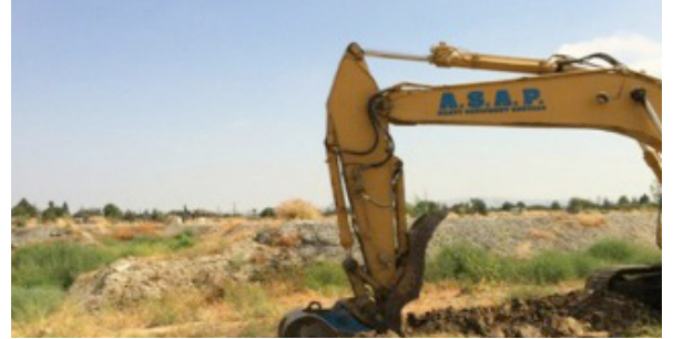
La excavación de suelo contaminado a DFSP Norwalk. El suelo contaminado será reemplazado con suelo limpio
